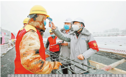
小汤山医院集装箱式病房区工程管理人员为雪天施工的工人测量体温。杨海超/摄
