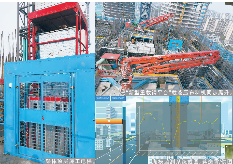
架体顶层施工电梯
