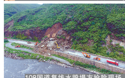
108国道复线水毁塌方抢险现场。
