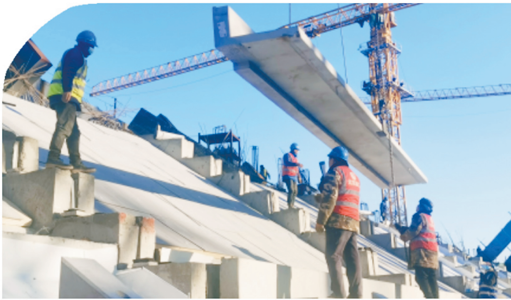
工人体育场改造重建项目施工人员正在安装看台板。刘东旭/摄
